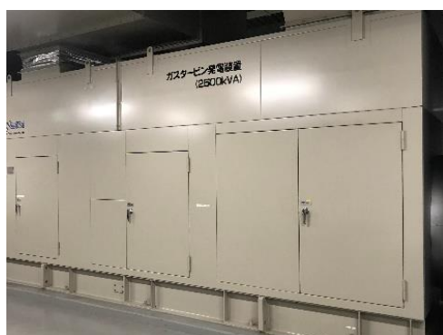
非常用発電施設
